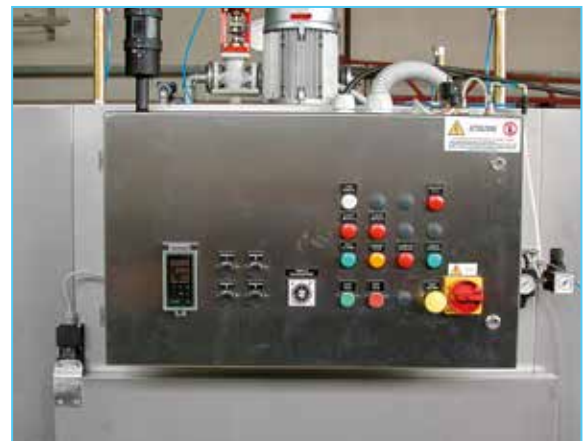
Quadro elettrico Control panel
